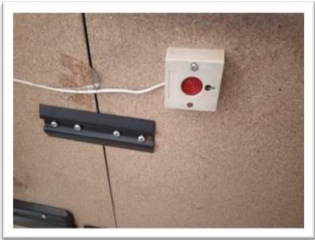
Fotografía 21, Botón de emergencia
